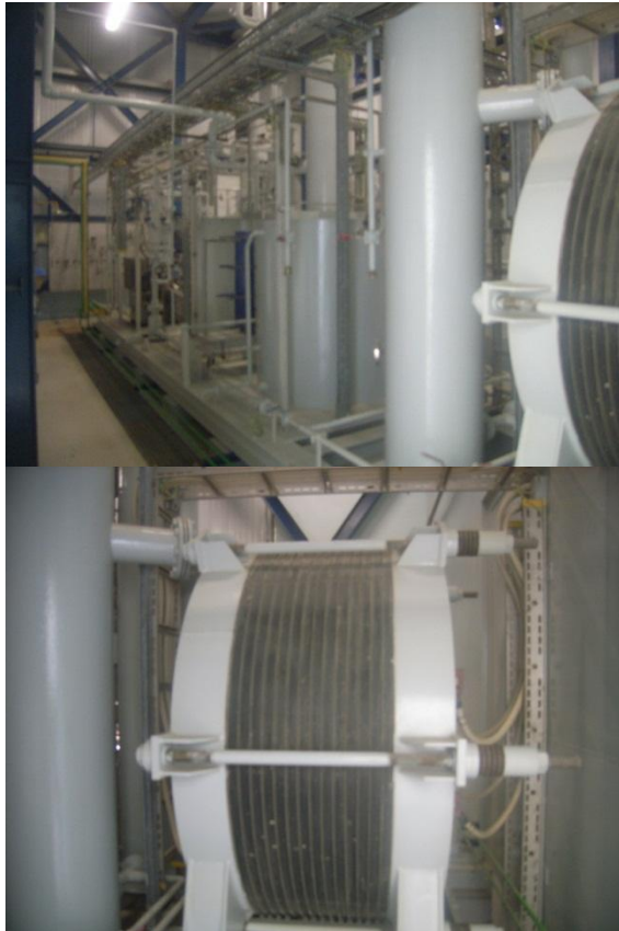
Fig.1.22. Station de production d'hydrogène
