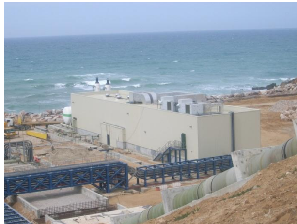
Fig.1.21. La station d'électro chloration.
