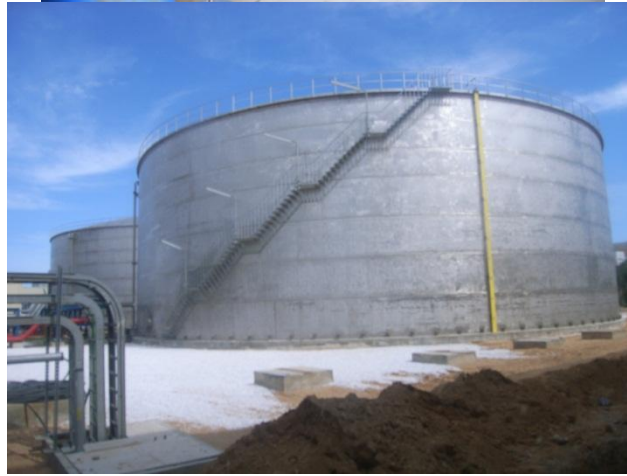
Fig.1.14. Salle de déminéralisation d'eau. Fig.1.15. les deux bacs d'eau déminéralisée.
