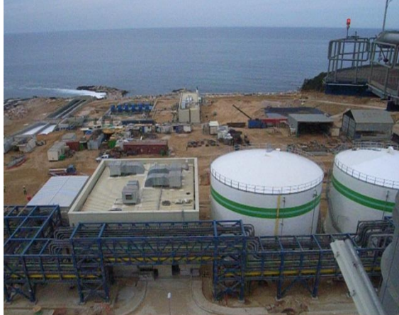
Fig.1.16. Salle de dessalement l'eau de mer. Fig.1.17. les deux bacs d'eau dessalée.
