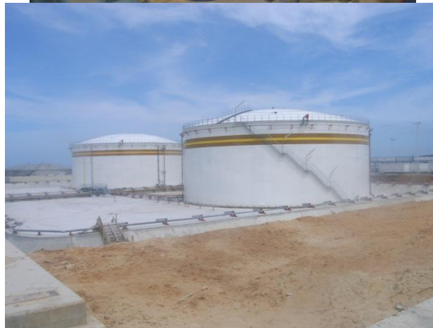
Fig.1.11. Station de traitement de gasoil.
