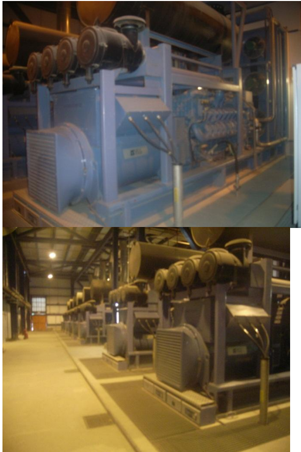
Fig.1.20. Bâtiment black Start.
