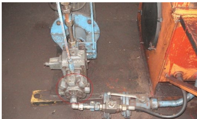
Figure 1.9-Pompe à pistons radiaux du banc d'essai
