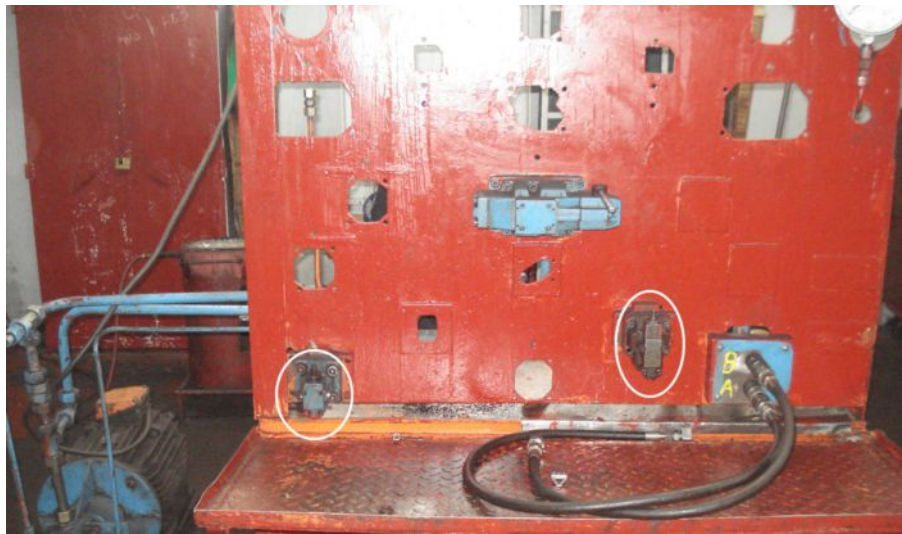
Figure 1.11-Les limiteurs de pression du banc d'essai
