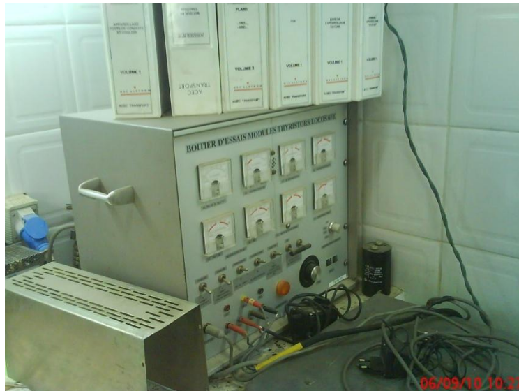
Figure I-5/D. Banc d'essai module thyristor locos 6FE.
