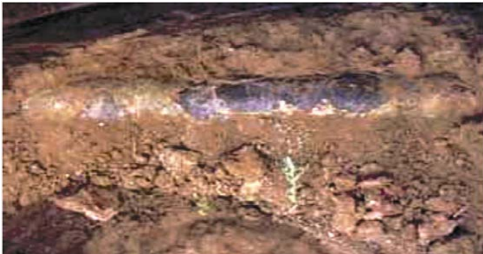
Figure V. 2 : Défaut de revêtement localisé par la méthode GVDC.
