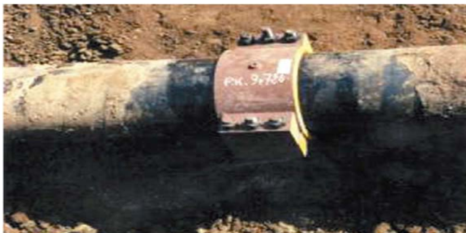
Figure V.5 : vue en plan d'un demi manchon boulonnée pour arrêter la fuite de gaz.
