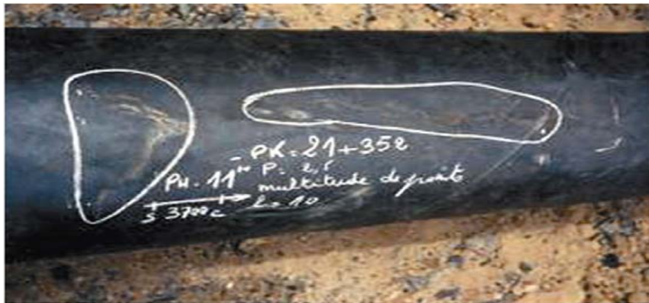
Figure V.3 : Multitude de points de corrosion de grade 2.
