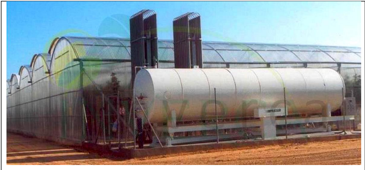
Figure I.13 : Réservoirs de CO 2 liquide [16].
