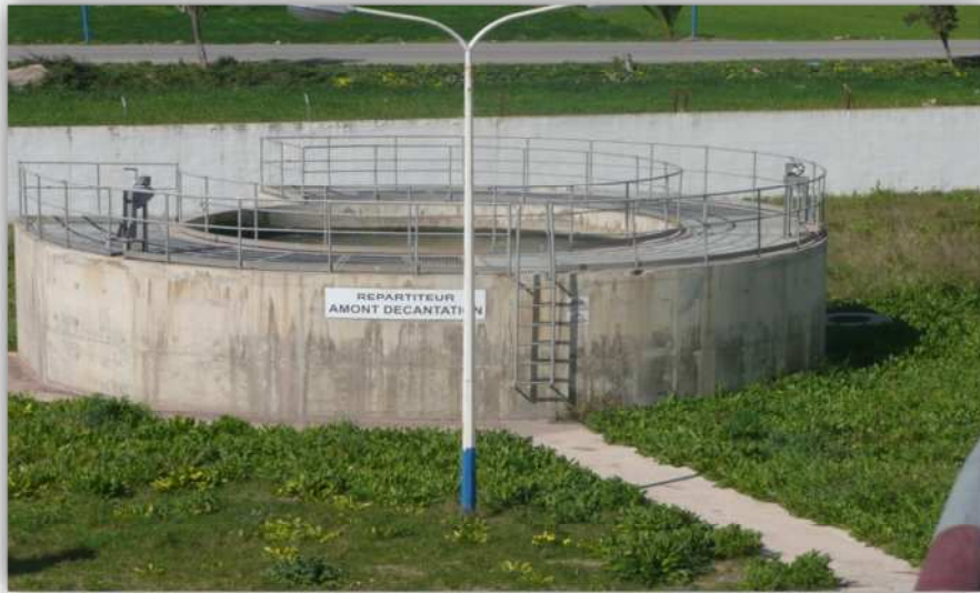
Photographie 3 : Répartition des eaux prétraitées.
