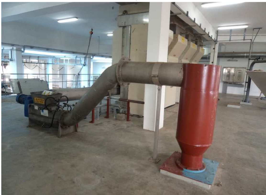
Photographie 1 : poste de dégrillage.
