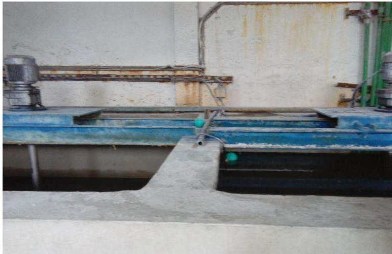
Photo 22 : Bac de préparation d'adjuvant
