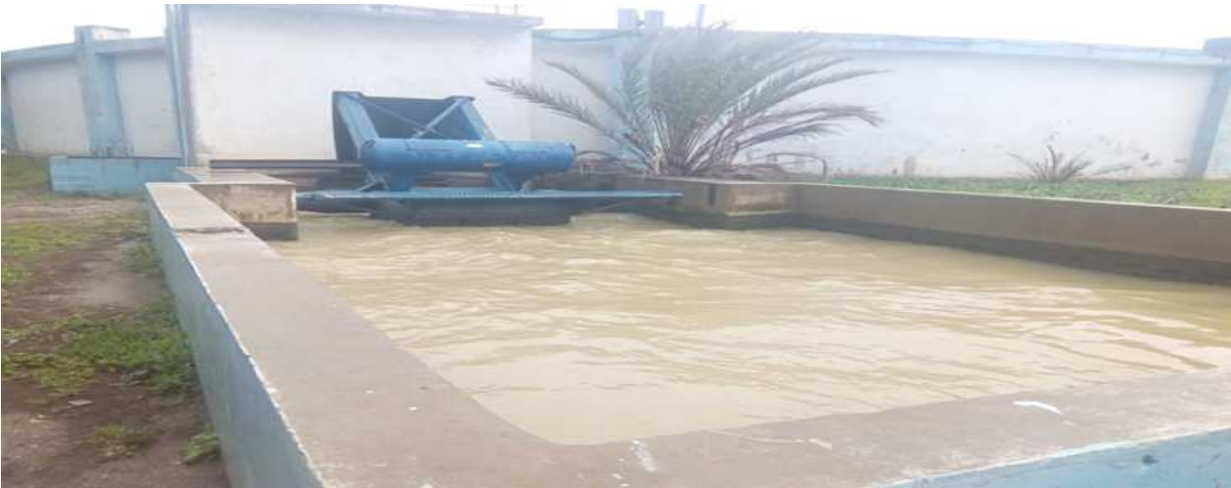
Photo 7 : Vanne Avio entrée station «CHAIBA »
