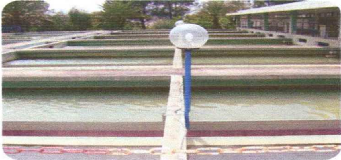
Photo10: Filtres à sable «CHAIBA»
