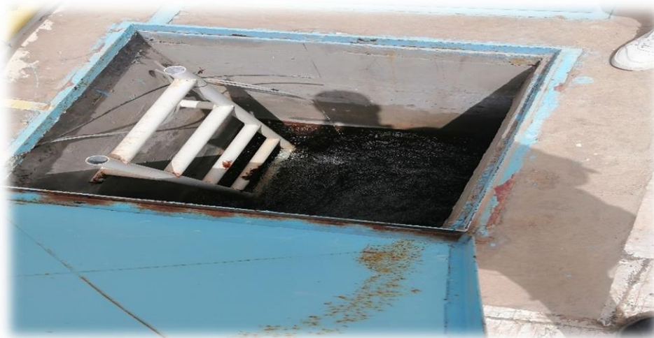
Figure III.9: Réservoir de mélange.
