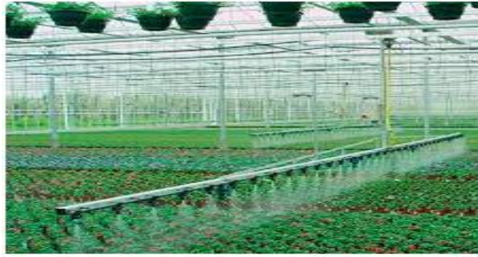
Figure 8: exemple : une rampe d'irrigation pour serre (Source : www.lemondeagricole.ca 23 avril 2019)
