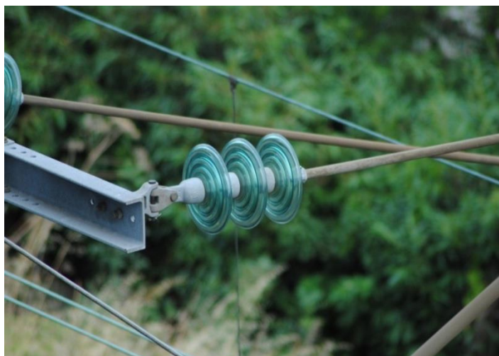
Figure I .2 chaines des isolateur
