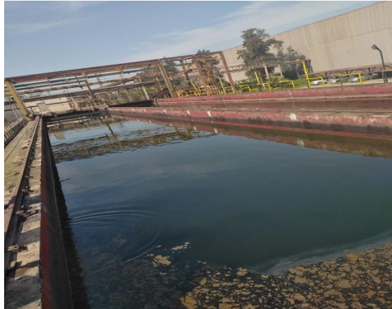
Figure I.7. Décanteur de l'unité de TSS
