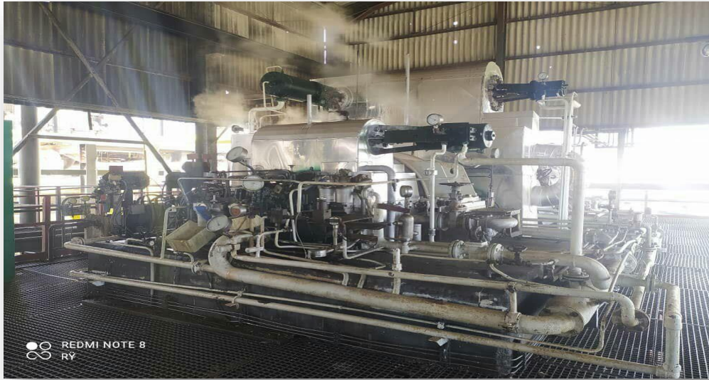
Figure.IV. 5. Salle des machines
