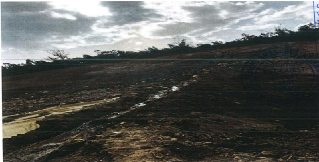
Figure II.5 – Etat actuel du glissement de talus
