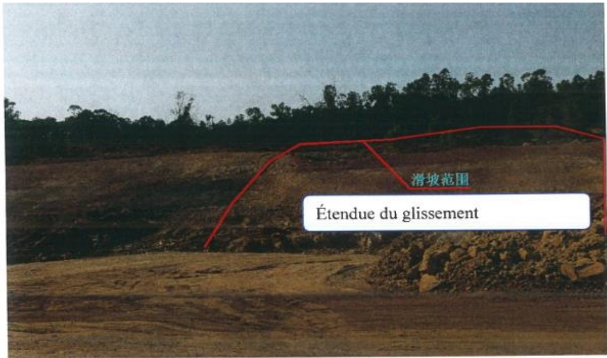
Figure II.6 – Etat actuel du glissement
