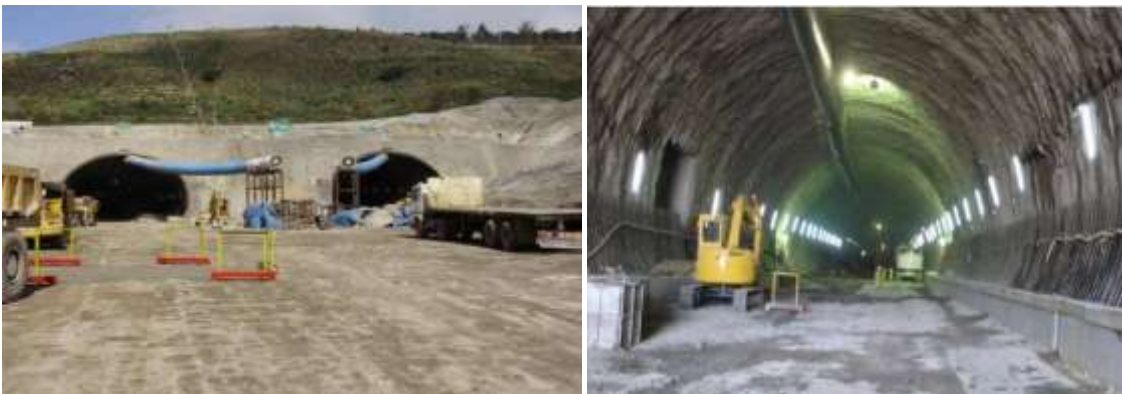
Figure 36 : Portails T1 Sud Droit et gauche
