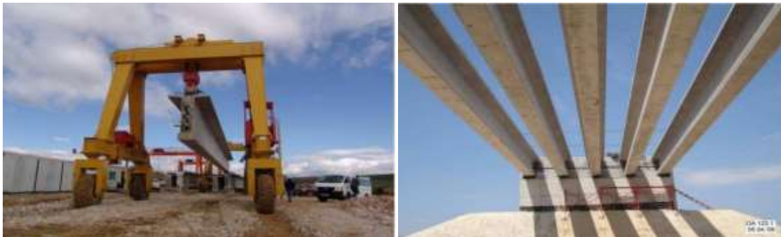
figure 34: Stockage des poutres par l'emploi de chariots Poutres en ouvre sur un P.S
