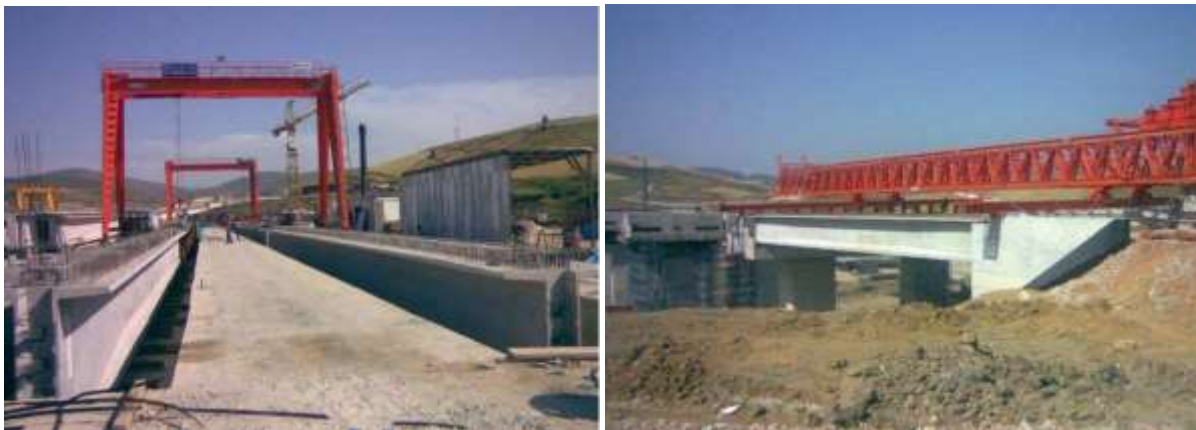
Figure30 : Camp 5: atelier de préfabrication des poutres Poutre de lancement en action à niveau de l'O.A
