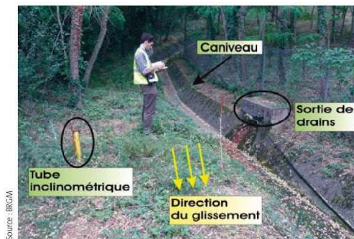
Drainage des eaux de surface à l'aide d'un caniveau (Alpes-Maritimes)
