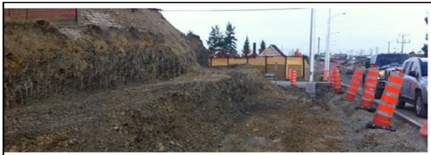
Figure 1.18 Les déblais et les excavations à la base du talus
