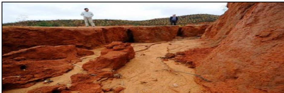
Figure 1.21 Glissement de terrain causé par la présence d'érosion
