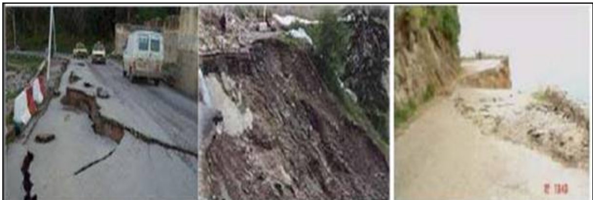
Figure 1.16 Instabilité des talus (cas des routes)
