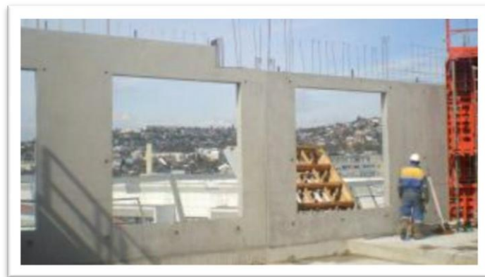
Figure 1.21 : Béton autoplaçant pour la réalisation de voiles , de poteaux et de poutres courants [63]
