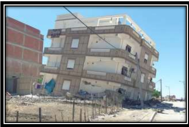
Effondrement total d'une habitation de 4 étages à cause d'une secousse tellurique de magnitude de 4,9 degrés sur l'échelle de Richter le 07/08/2020 à MILA
