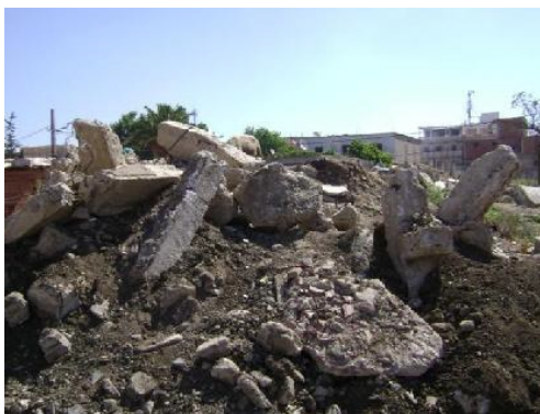
Débris de béton
