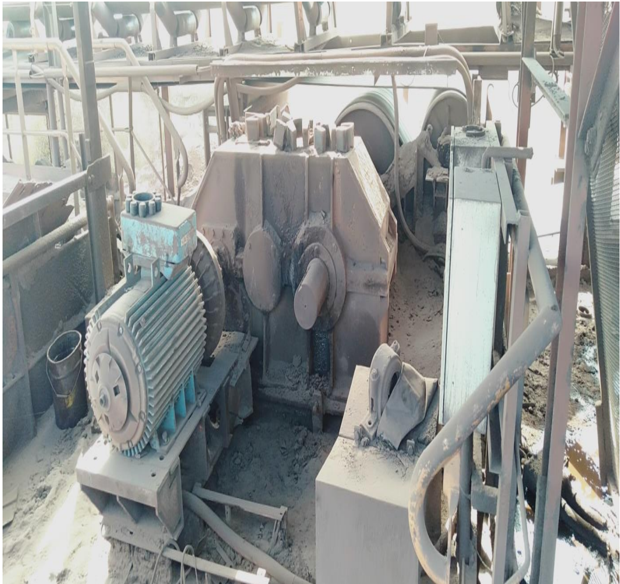
Figure I.7 : Réducteur de l'entreprise du complexe Sider EL-HADJAR.
