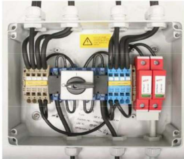
Figure II.10: Exemple de boîte de jonction et câblage
