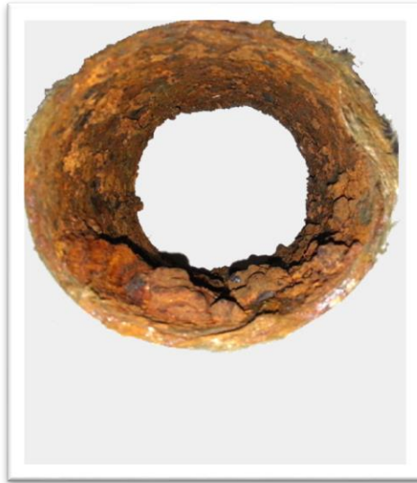
Figure I.3 : une Conduite ayant subi de tartre,rouille, calcaire de corrosion interne
