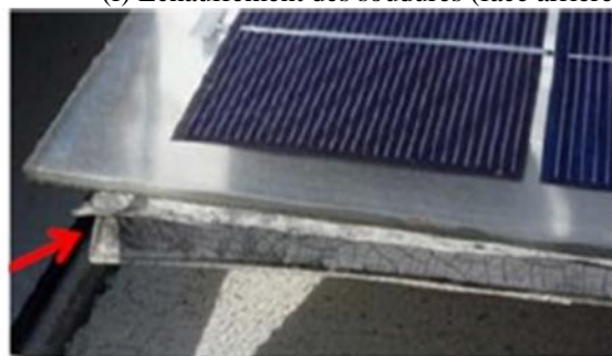
(h) défaut mécanique de la face arrière
