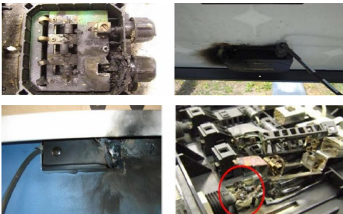
Figure 2 : Exemples de défauts rencontrés dans des boîtes de jonction.
