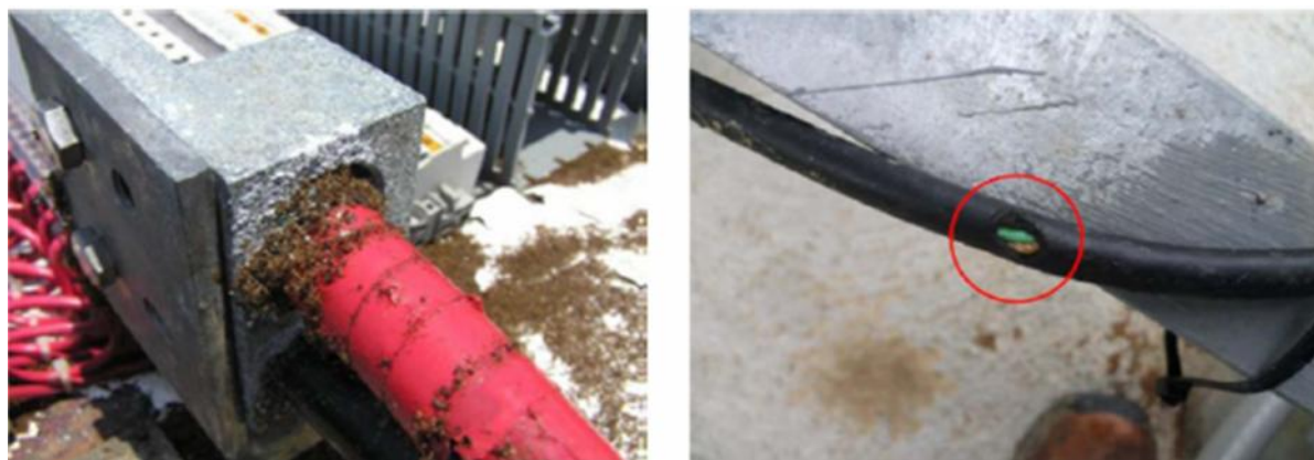
Figure 3 : Exemples de défauts rencontrés dans le système de câblage.
