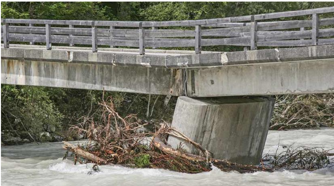
Figure I.6. Dommages causés par l'action dynamique des eaux de crue de surface ( https://bridgemastersinc.com ) (15/10/2017)
