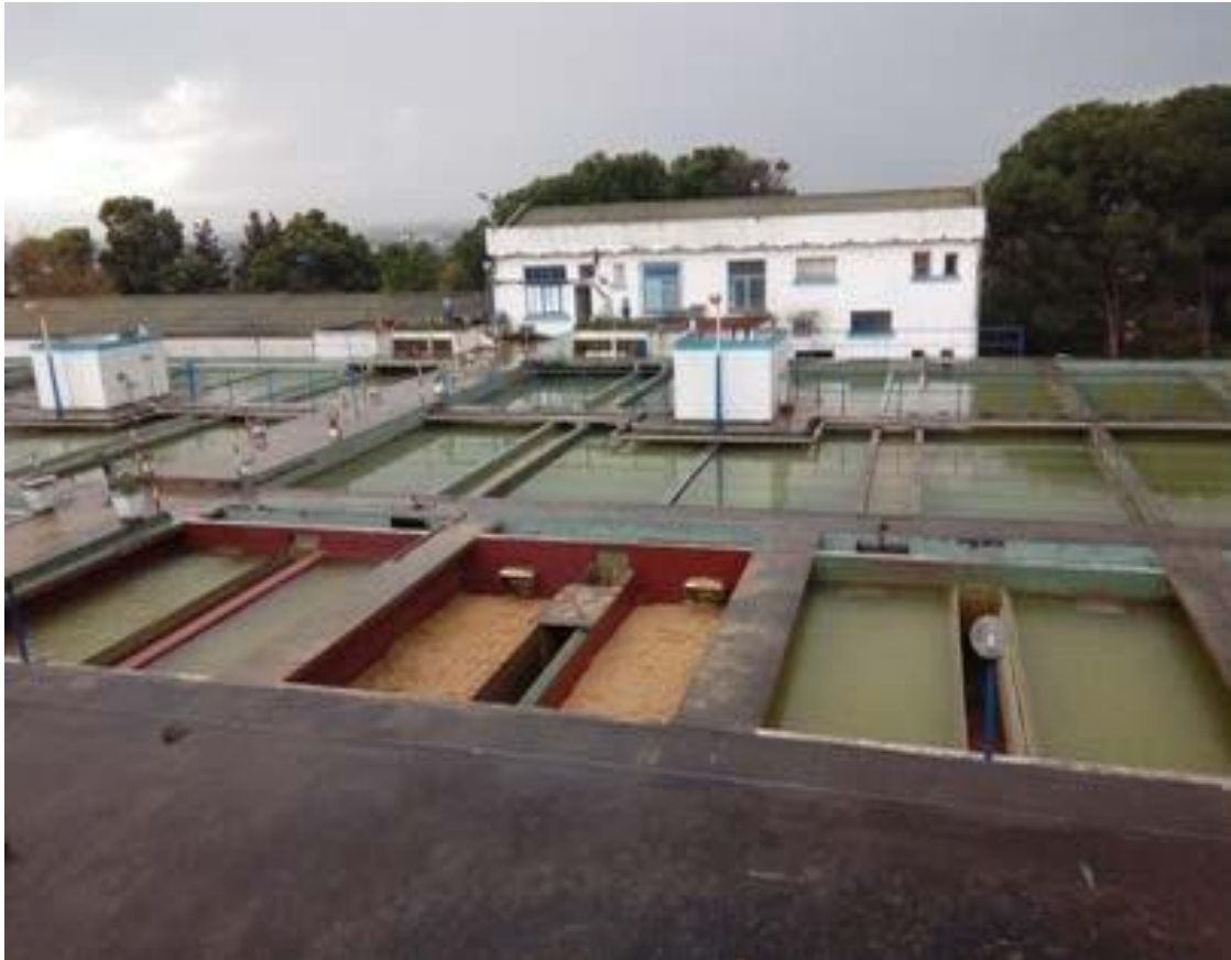
Figure n°11 : Station de traitement des eaux «CHAIBA»
