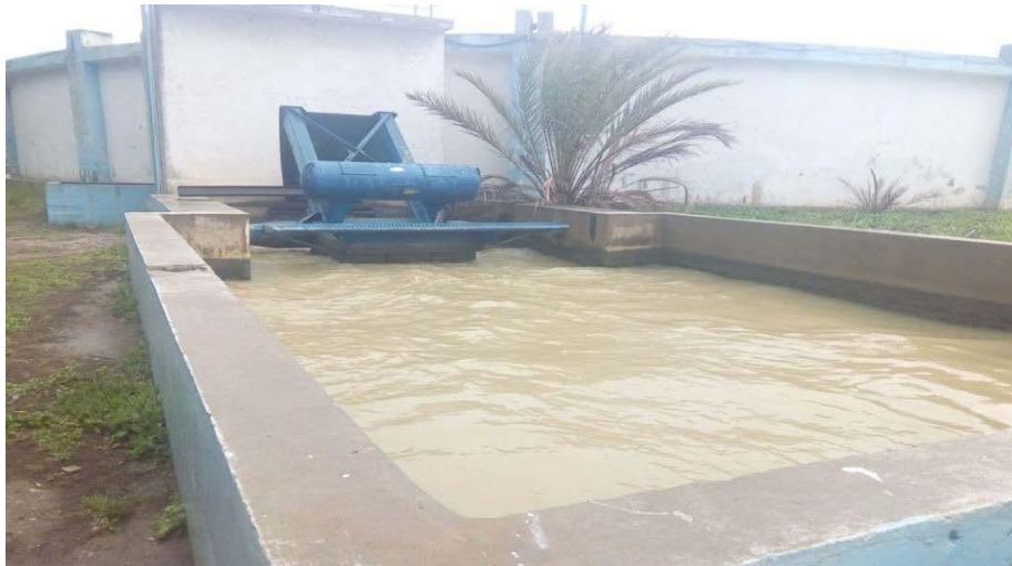
Figure n°13 : Vanne Avio entrée station «CHAIBA »
