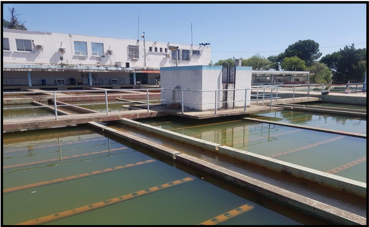
Figure n°20 : Vue générale d'un décanteur PULSATOR « Chaiba »
