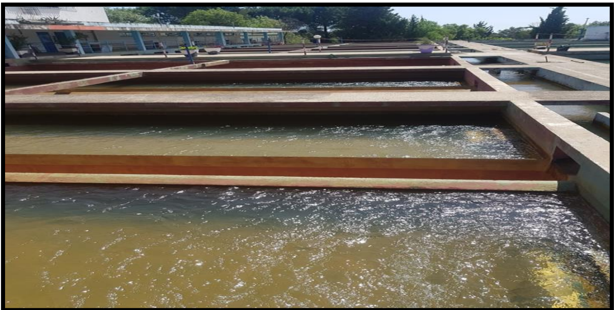
Figure n°26 : Filtres à sable « Chaiba »
