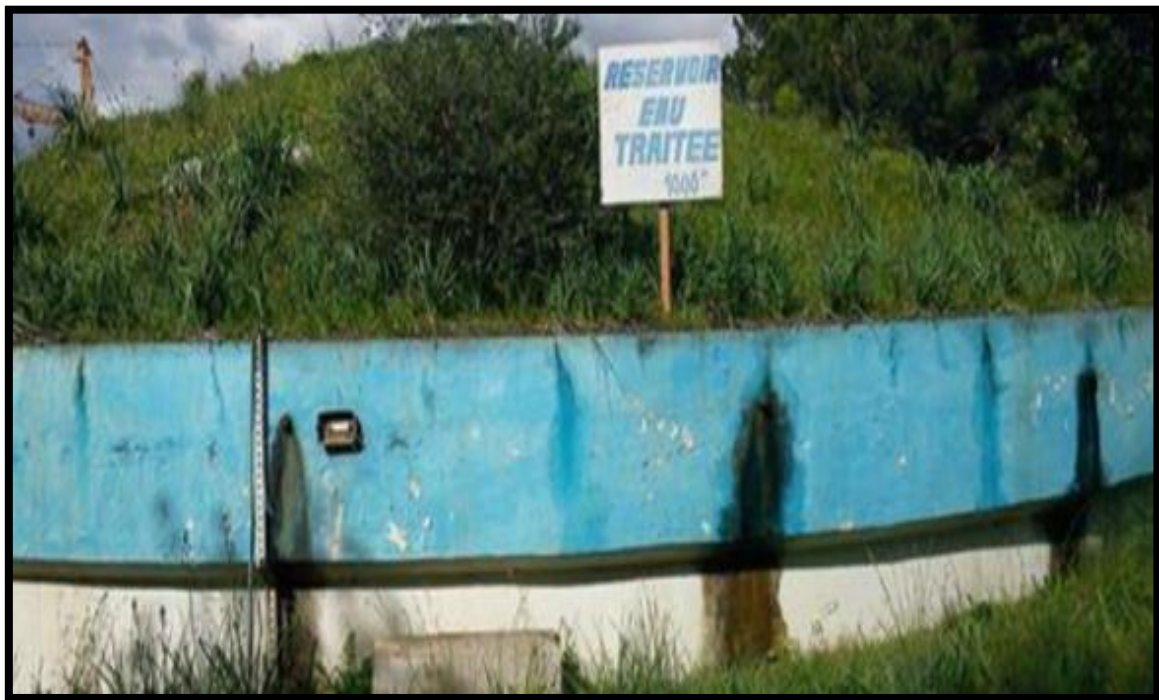
Figure n°30 : réservoir d'eau traitée « Chaiba »
