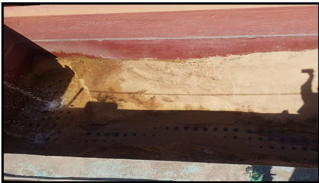
Figure n°14 : bassin de filtration
