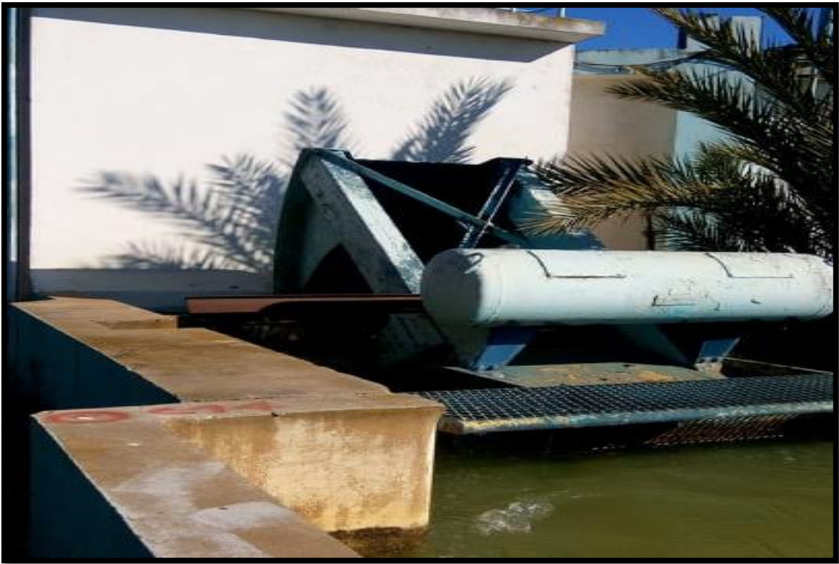
Figure n°19 : Vanne Avio entrée station « Chaiba »
