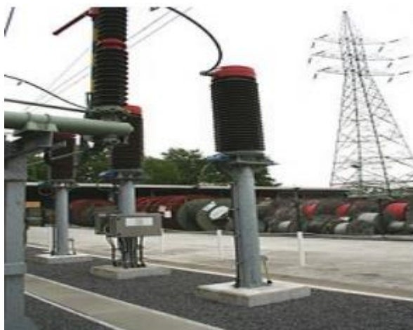
Figure IV : 14 transformateurs de tension
