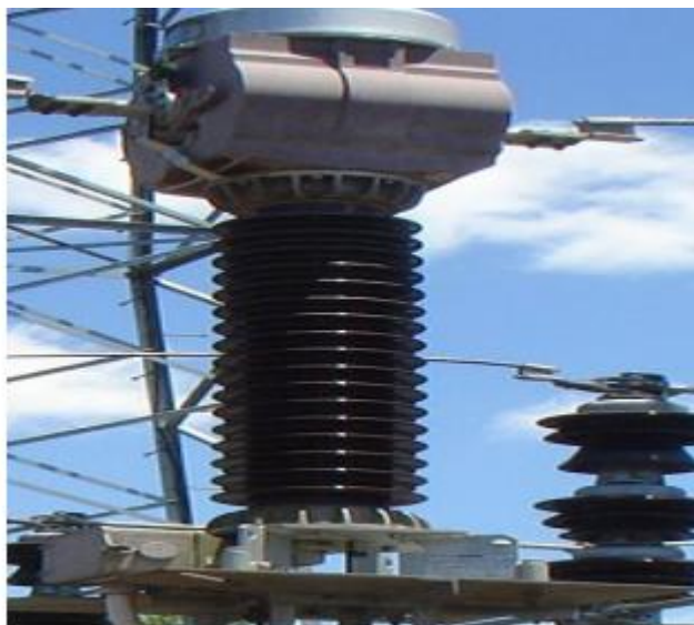
Figure IV : 13 Transformateur de courant
