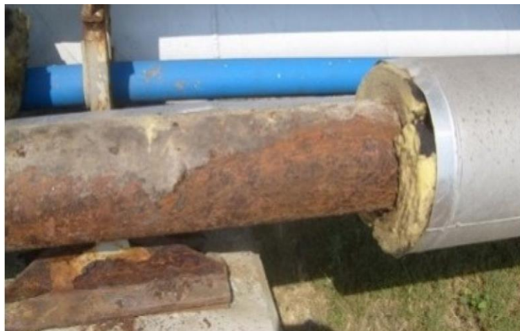
Figure 1-7 : corrosion sous calorifuge [34]
