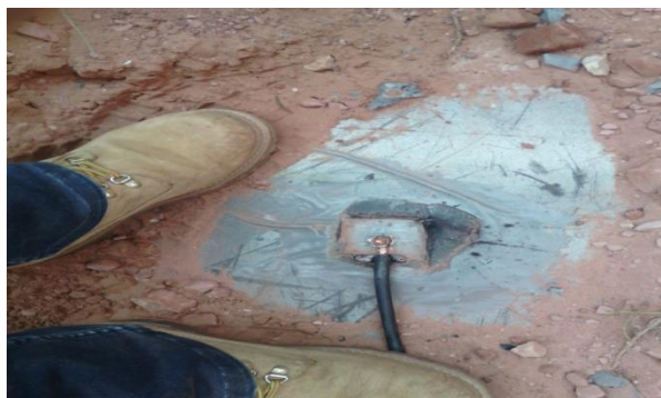
Figure 1-17 : photo réel d'une protection cathodique d'un tuyaux
