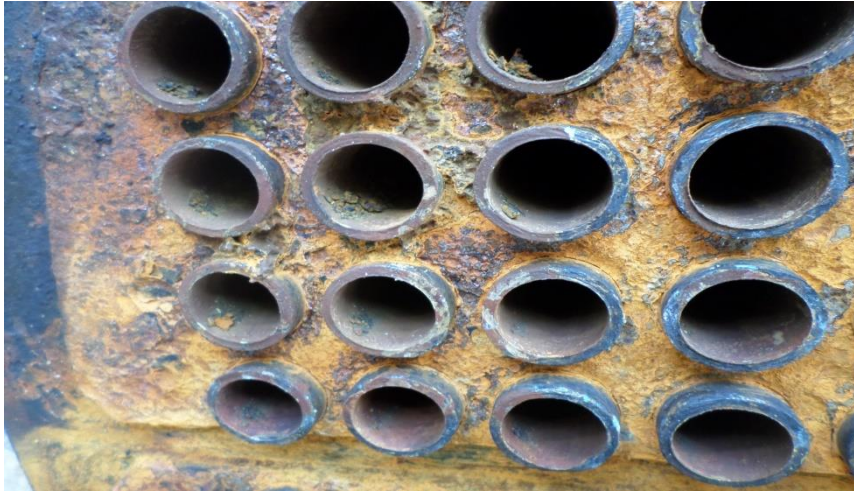
Figure 1-2 : corrosion galvanique coté calandre de l'échangeur
