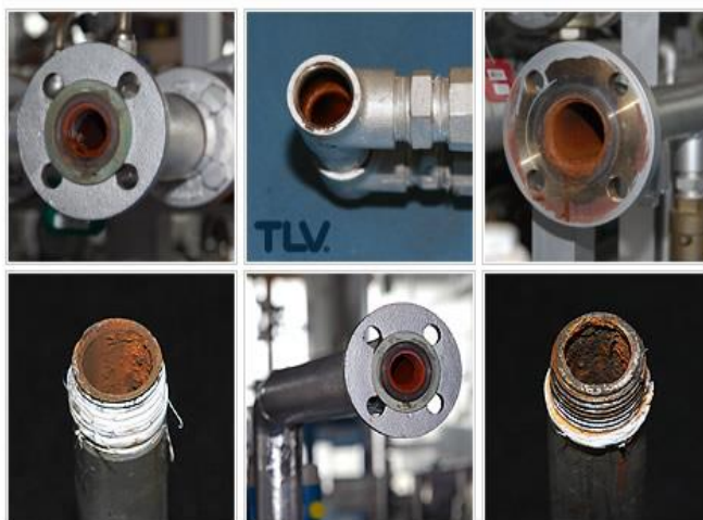
Figure1-13 : corrosion par la vapeur d'eau[38]
