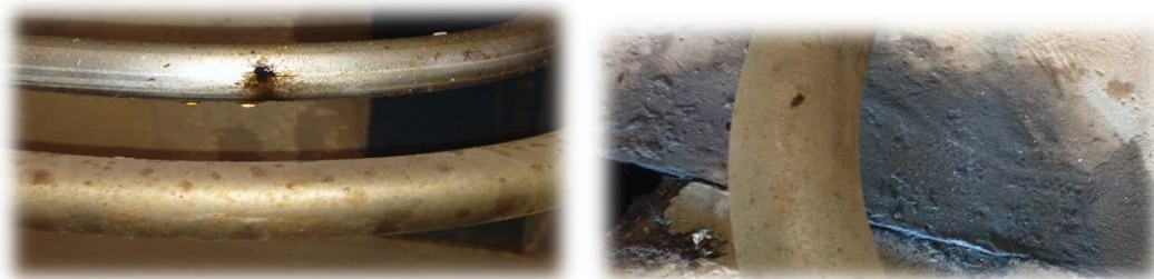
Figure17 : Une fuite d'huile hydraulique due de la corrosion.
