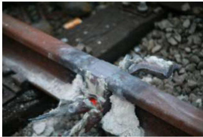
Figure II.13: Une soudure bien exécutée juste après l'ébavurage
