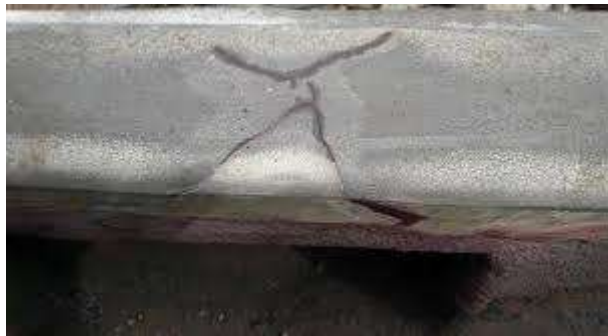
Figure II.24: Défauts de soudure
