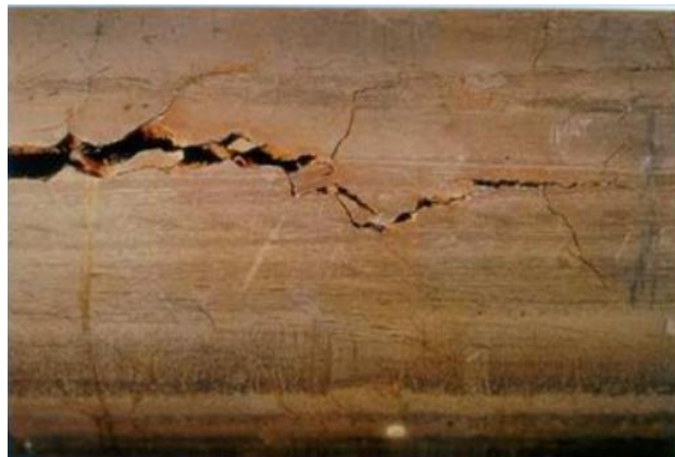
Figure – I.7 : Corrosion sous contrainte d'un tube en acier inoxydable [17]
