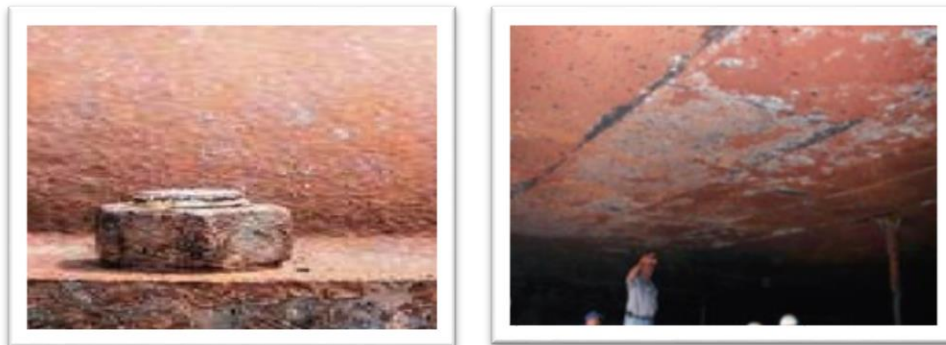
Figure – I.1 : Corrosion généralisée
