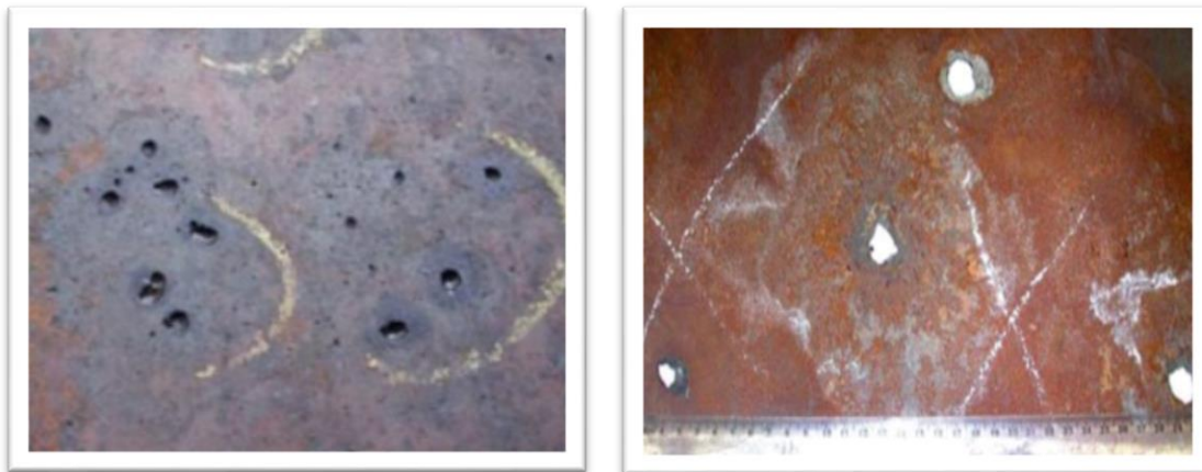
Figure – I.2 : Corrosion par piqure
