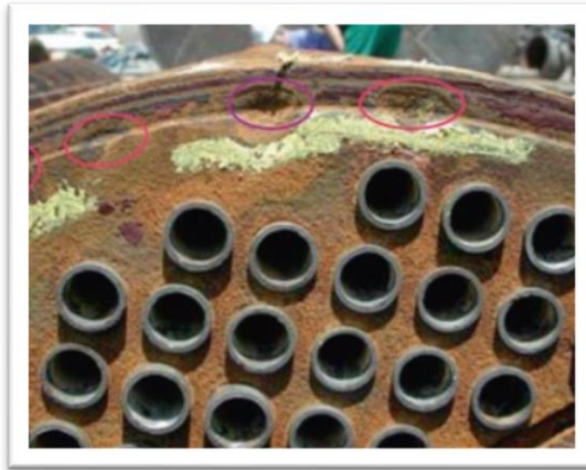
Figure – I.4 : Corrosion par crevasse entre plaque tubulaire et tubes d'échangeur
