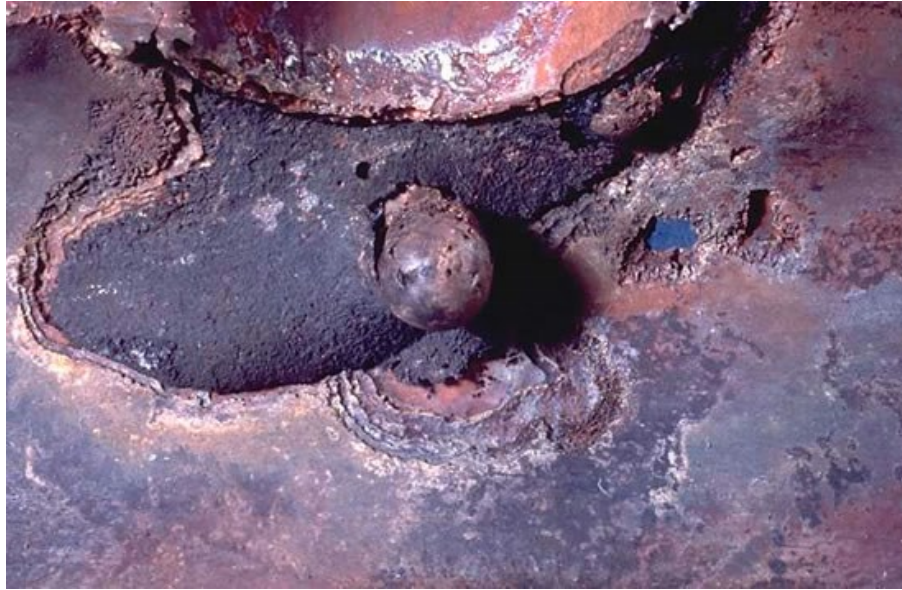
Figure 6 Corrosion galvanique d'une pièce
