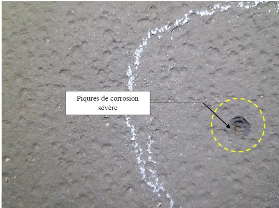
Figure 44 Piqures de corrosion sévère
