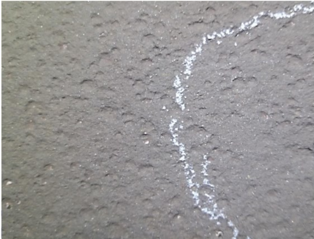
Figure 50 Regroupement de piqures de corrosion légère formant un nid
