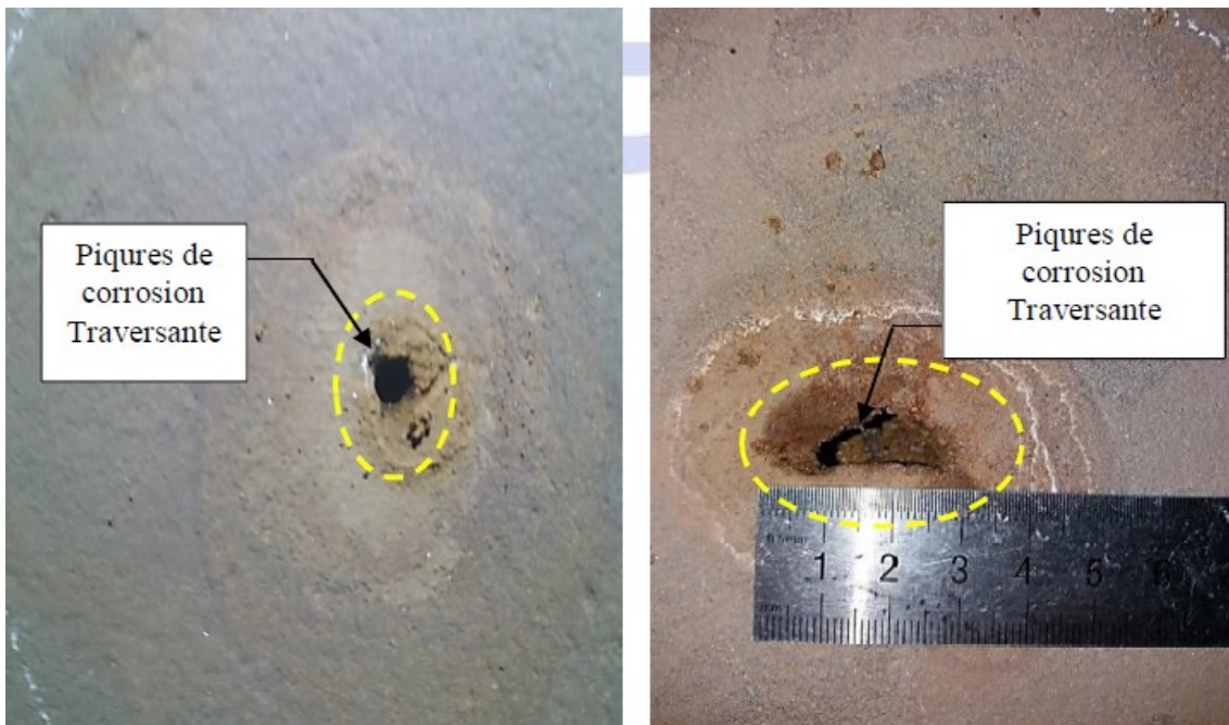
Figure 45 Piqures de corrosion traversante
