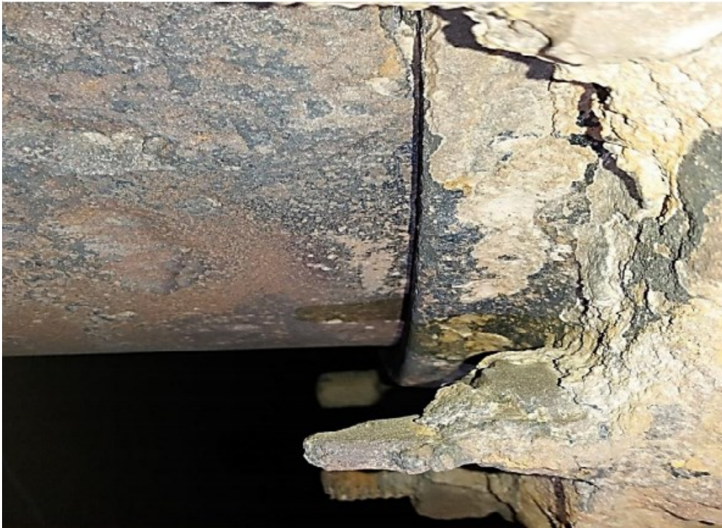
Figure 58 : Dégradation par corrosion de la bride de la ligne d'expédition côté arrière
