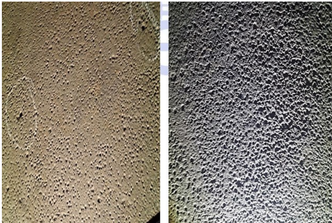
Figure 51 Regroupement de piqures de corrosion sévère formant un nid
