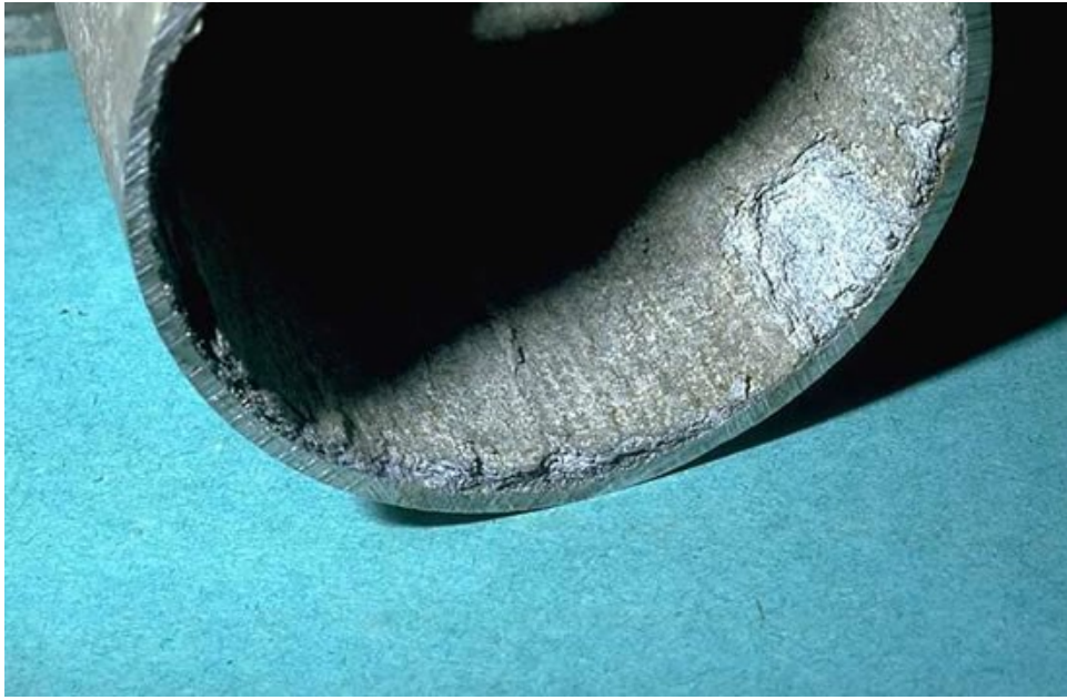
Figure 8 Corrosion feuilletante d'une canalisation en alliage d'aluminium véhiculant de l'eau
