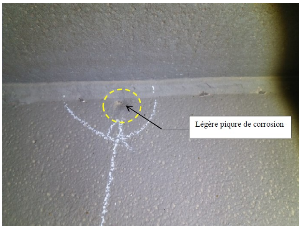
Figure 43 Pique de corrosion légère
