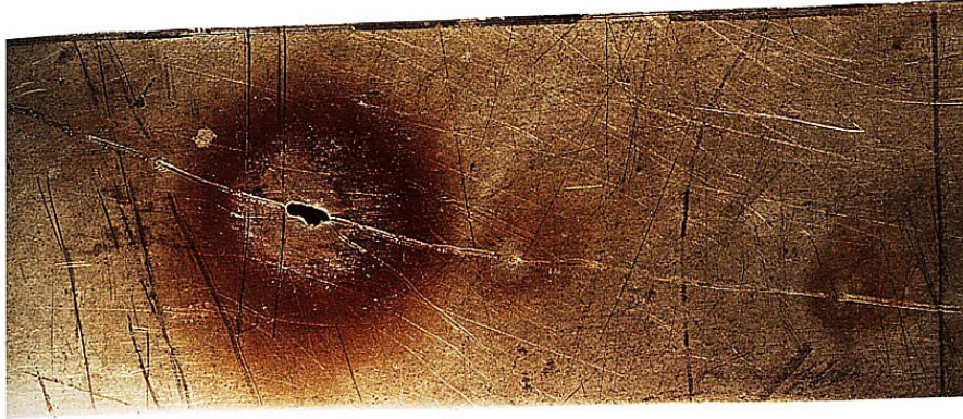
Figure 3 Corrosion par piqûres sur la paroi d'une cuve en acier inoxydable austénitique Cr18-Ni10
