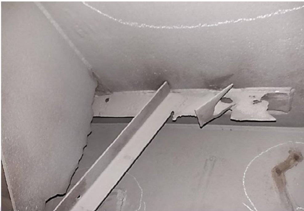
Figure 59 Dégradation par corrosion des supports de tubes de jaugeage
