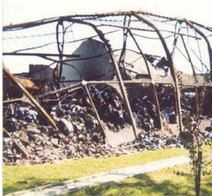
Figure 1.9. Structure en acier effondrée vers l'intérieur
