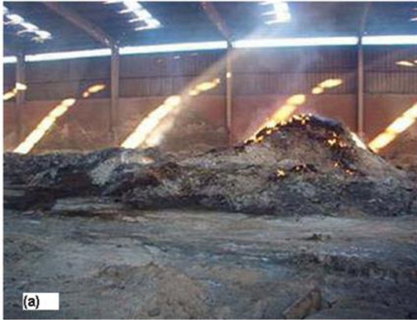
Figure 1.6 Ruine partielle du bâtiment
