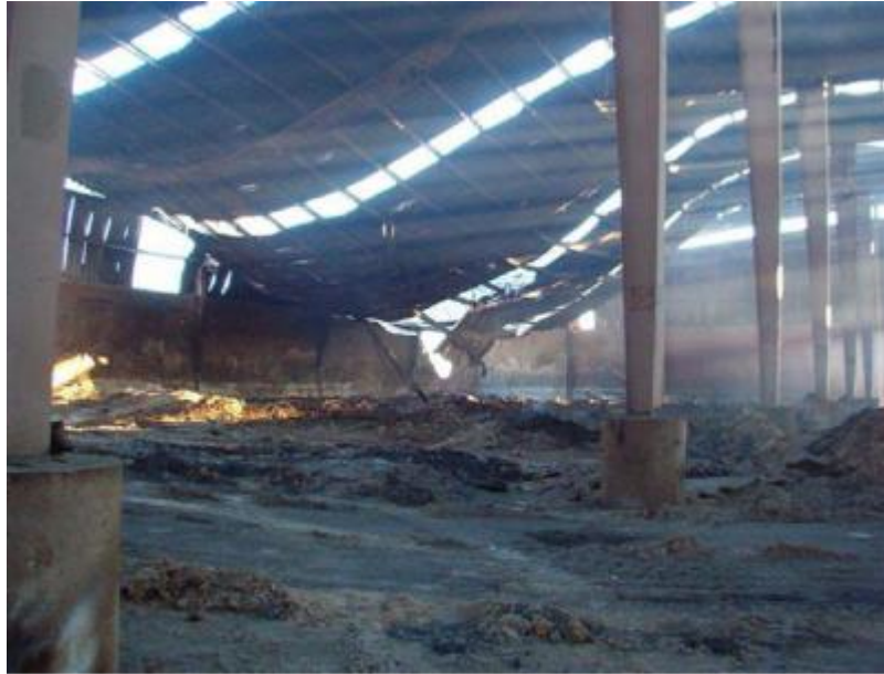
Figure 1.7 Ruine partielle du bâtiment
