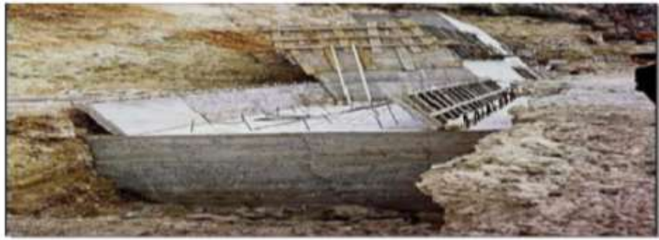
Figure IV.13 : Exemple d'ouvrage rigide : Mur en béton armé (Service d'Etude Technique des Routes et Autoroutes (SETRA)).
