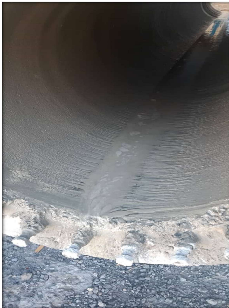
Figure 51-l'eau en excès après un arrosage du tuyau
