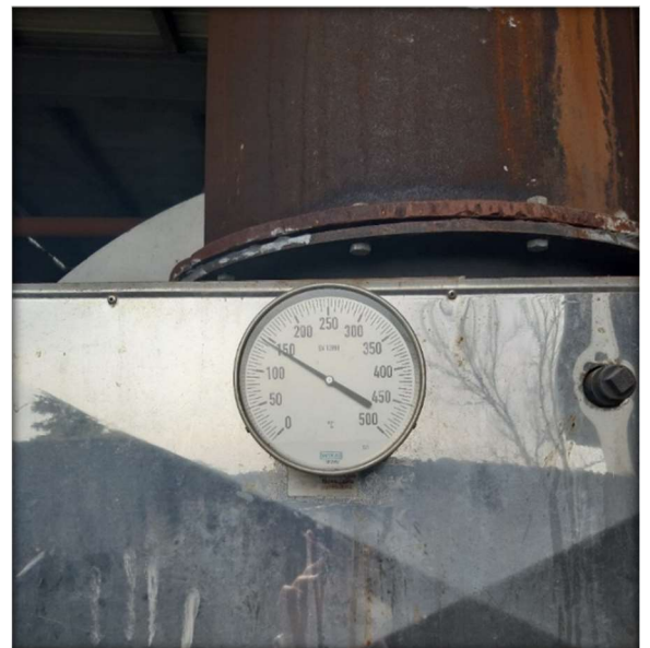
Figure 53-chaudière à 150°C de température
