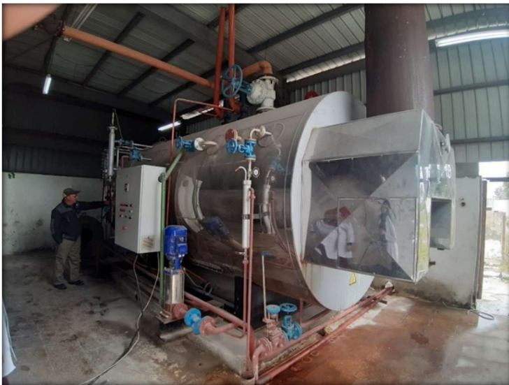
Figure 52-chaudière à vapeur
