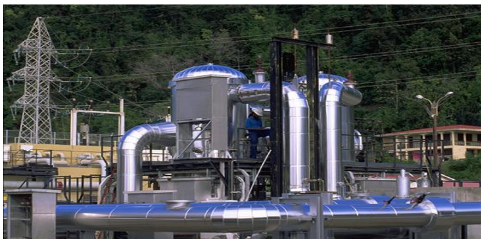
Figure (I.4) : une centrale géothermique
