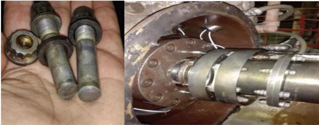
FIGURE 54 : photo réel du cisaillement du boulon de l'accouplement du compresseur à basse pression
