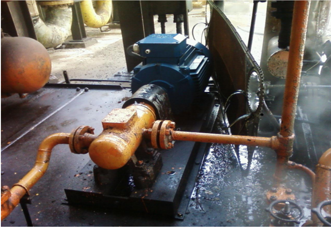
FIGURE.26 : Les conduites d'aspiration d'une moto pompe d'huile d'étanchéité [04]
