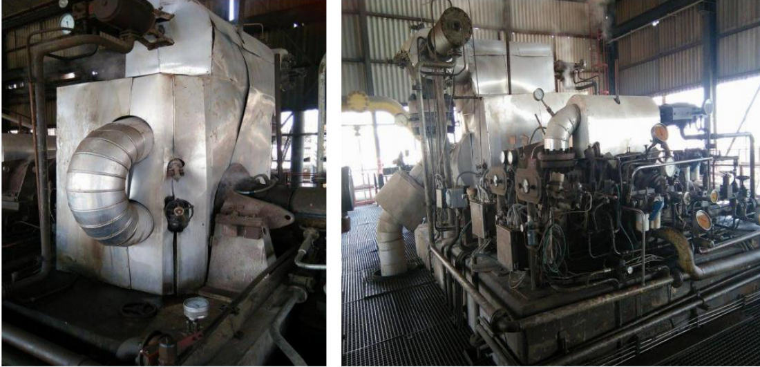
Figure 18 : les turbines de la (103-JBP ,103J-HP) [4]
