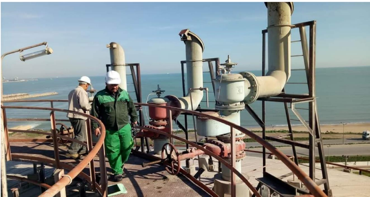
Figure 3. 13.le contrôle des soupapes
