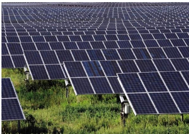
Fig-1- 2 Centrale photovoltaïque
