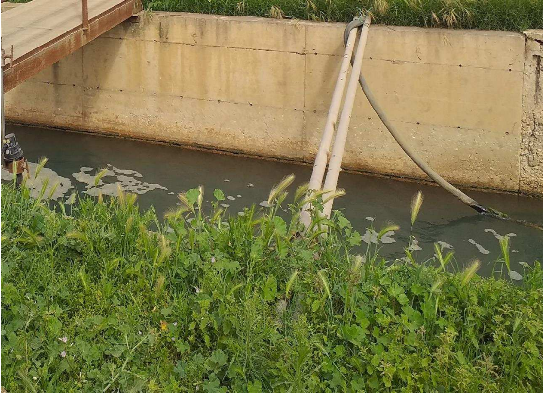
Figure. V-12 : Le point de rejet en aval de la zone nord.
