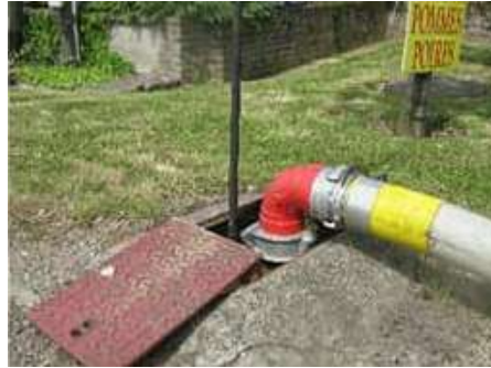
Fig.II.06. bouche d'incendie [CON].
