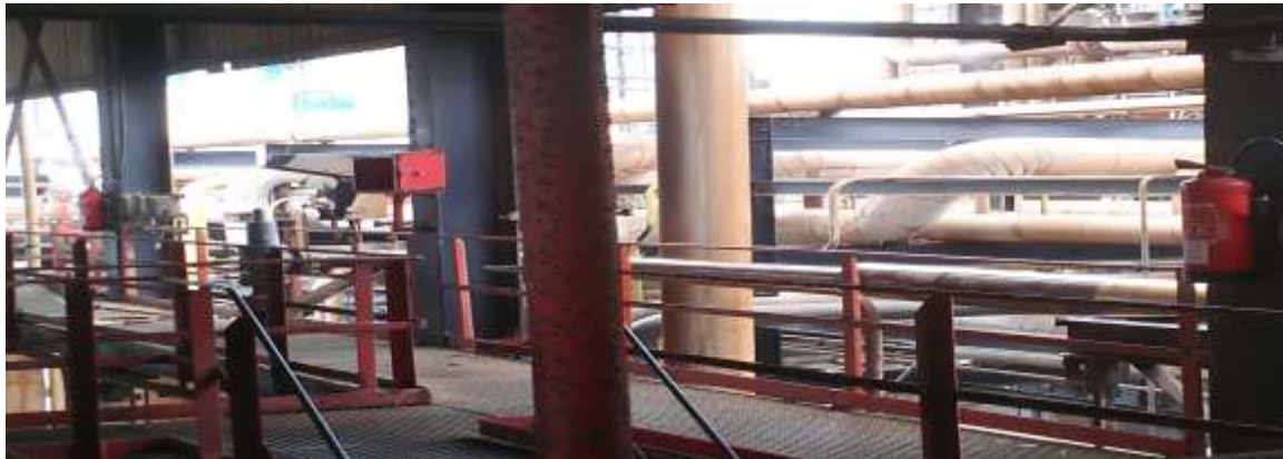
Fig.II.03. Implantation des extincteurs au niveau unité ammoniac FERTIAL
