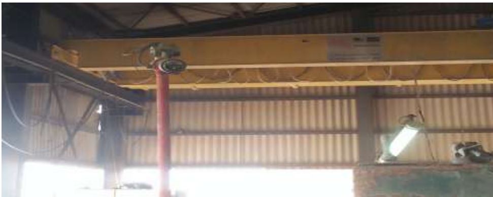
Fig. II.12 Détecteurs de flamme salle des machines unité ammoniac FERTIAL
