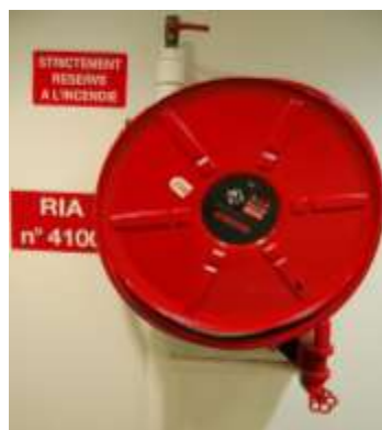
Fig.II.04. Robinet d'incendie armé [WIK].
