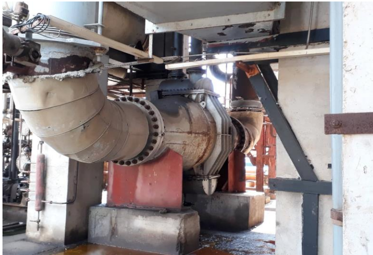
Fig. (I.4) : compresseur de l'air.
