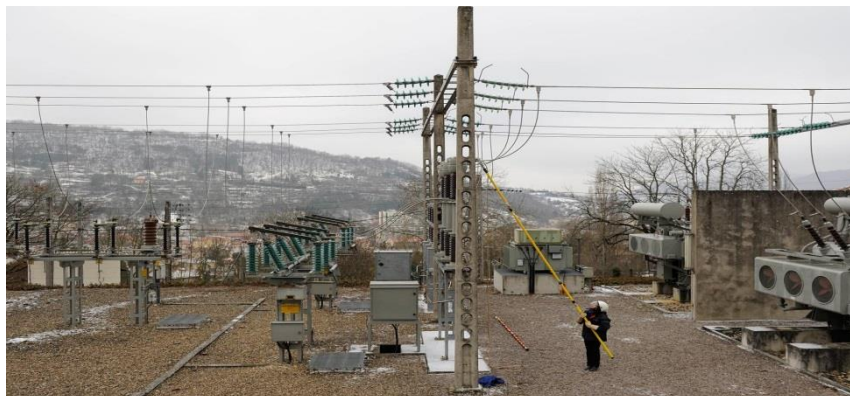
Figure 1.11 : accident d'origine électrique
