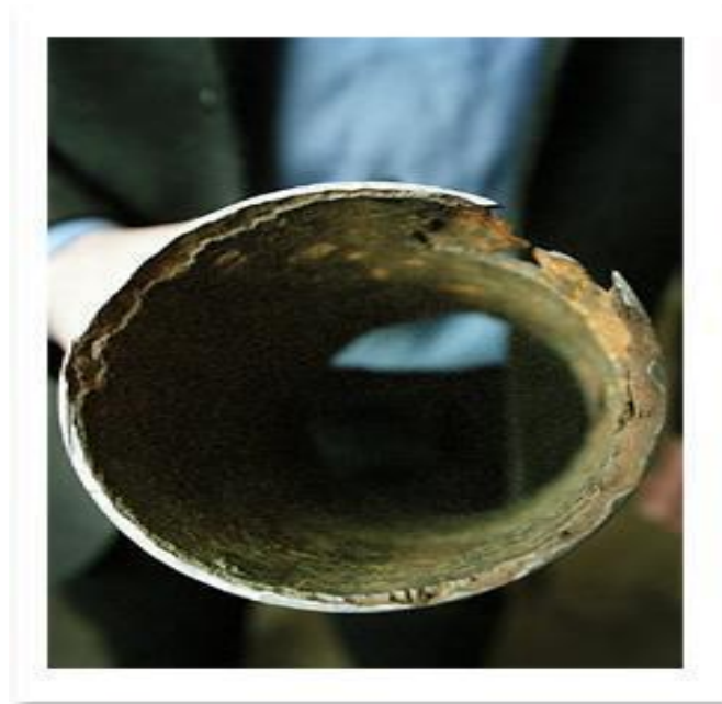
Figure I.1 : Une conduite ayant subi une rupture en Acier
