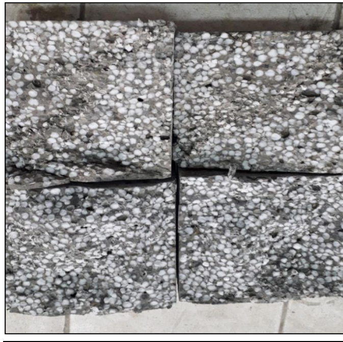
Figure IV.15 : Vue de la macrostructure des BS à base des granulats de polystyrène
