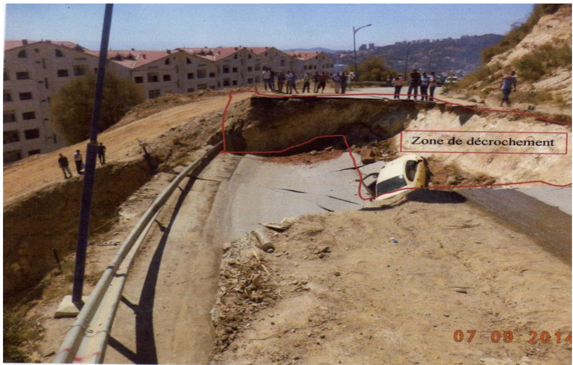
Figure II-4 : Vue sur l'autre coté du glissement (zone décrochement de la masse rocheuse)
