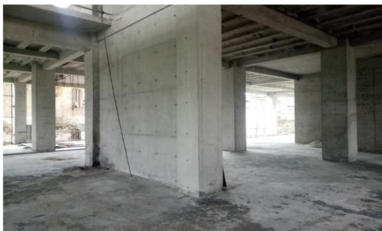
Figure II- 16-17-18 : Des voiles qui ont été touche par l'incendie avant et après le sablage
