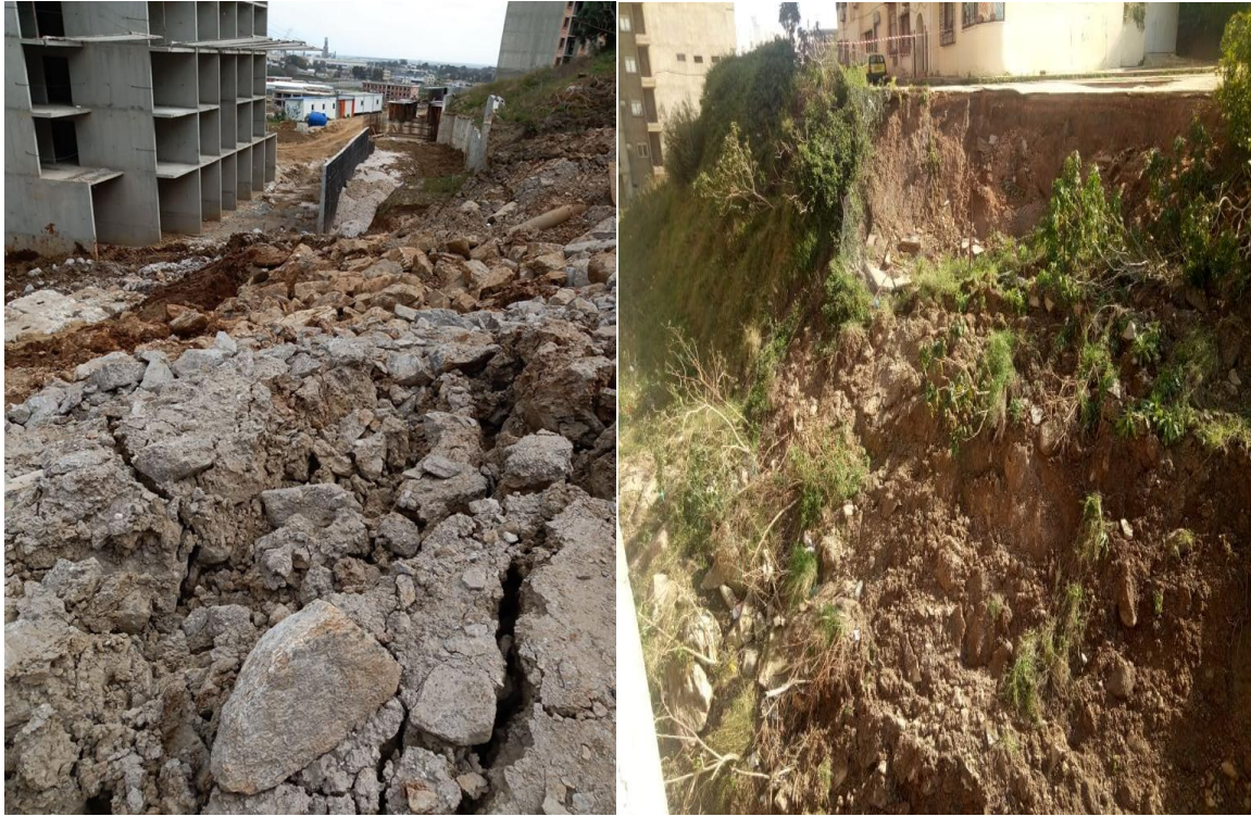
Figure V-02.03 : glissement de terrain
