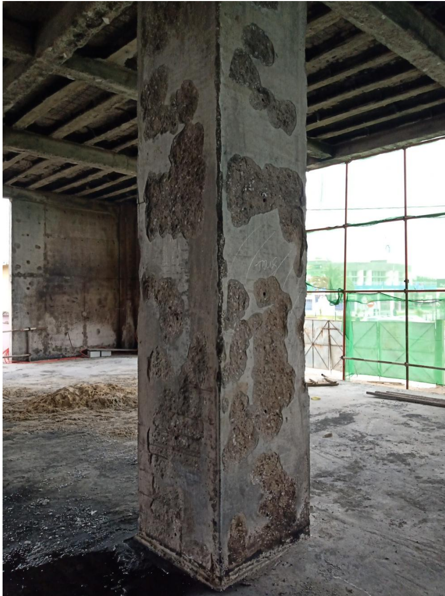
Figure II- 06 : phénomène d'écaillage dans un poteau
