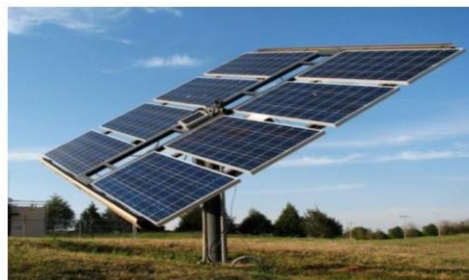
Figure (III.12) : panneau solaire
