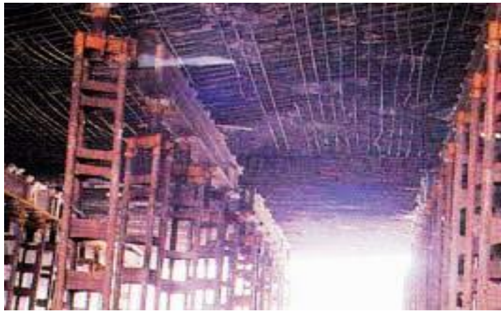
Figure II.17: Eclatement du béton suite à un incendie de parking
