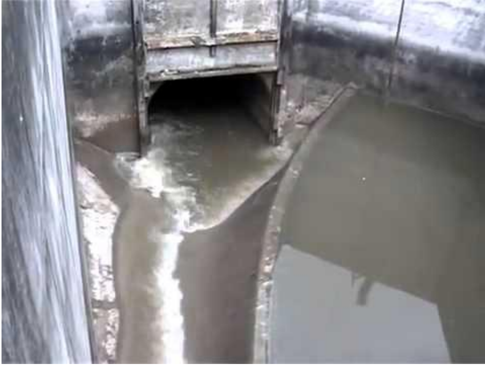
Figure I.10 : Un déversoir d'orage
