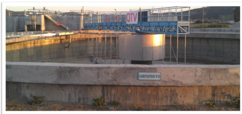
Figure 16 : Un clarificateur de la STEP
