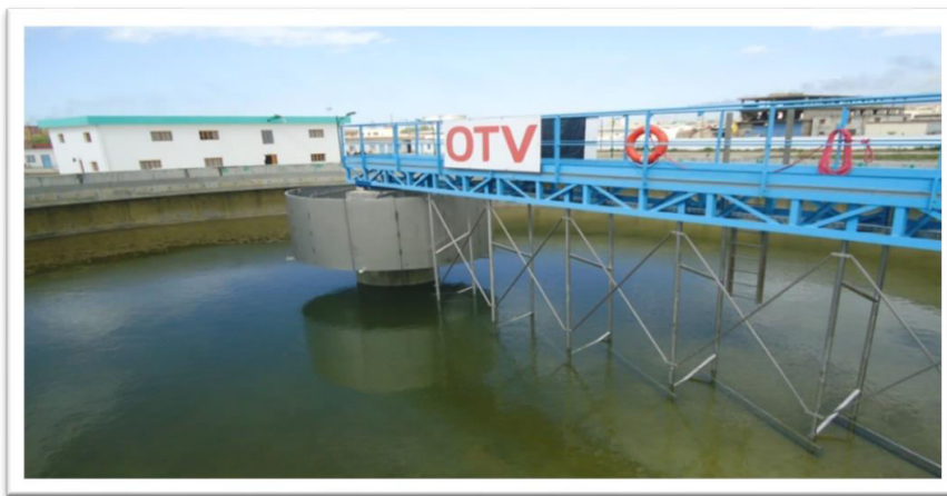
Figure 13 : Décanteur primaire de la STEP
