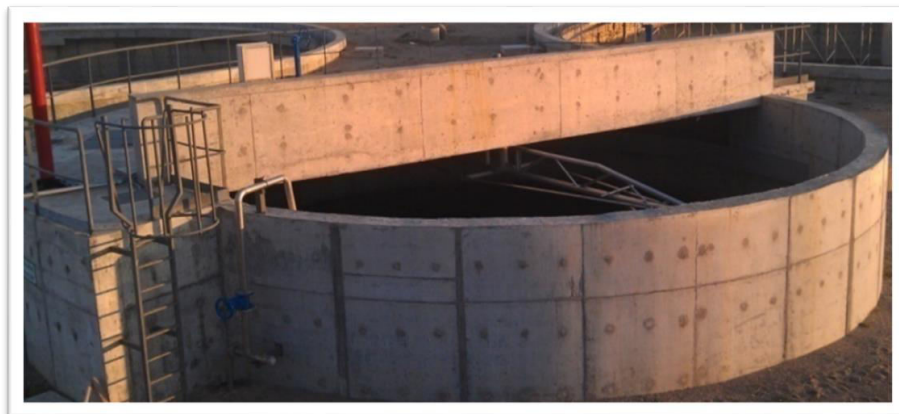
Figure 15 : Dégazeur de la STEP
