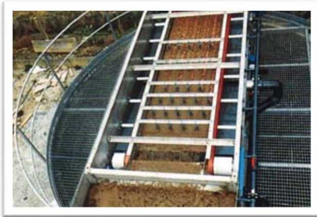
Figure 25 : Grille d'égouttage des boues
