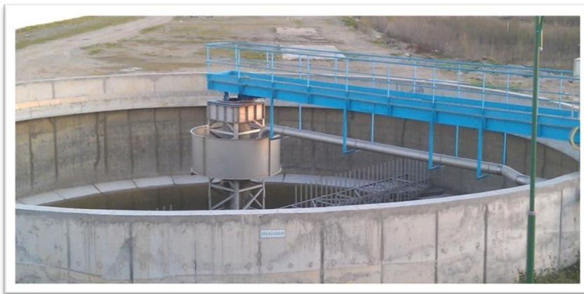
Figure 21 : Epaississeur de la STEP
