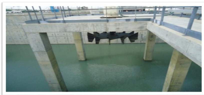
Figure 14 Bassin d'aération avec les turbines en arrêt
