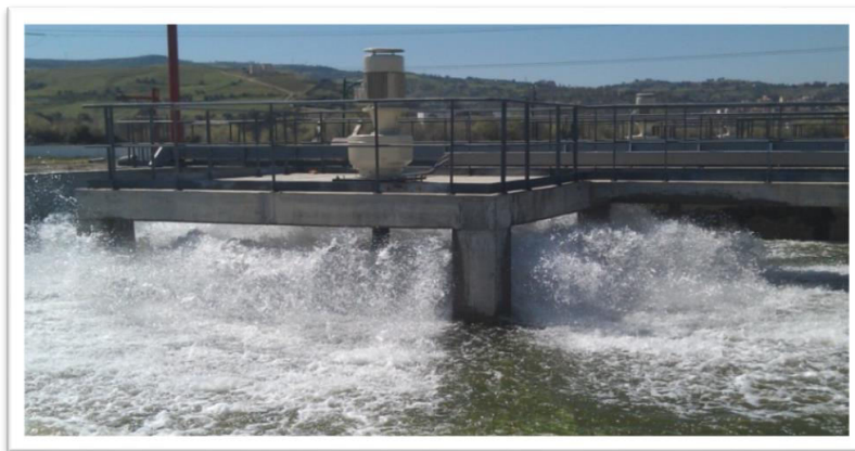
Figure 13 : Bassin d'aération avec les turbines en marche
