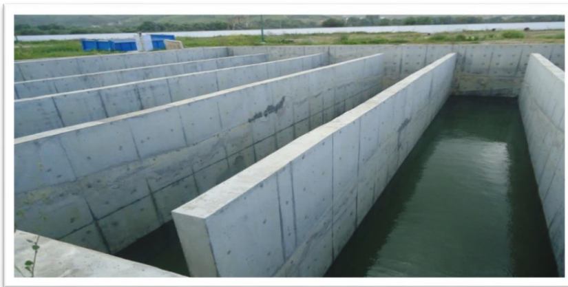
Figure 18 : Bassin de Désinfection de la STEP
